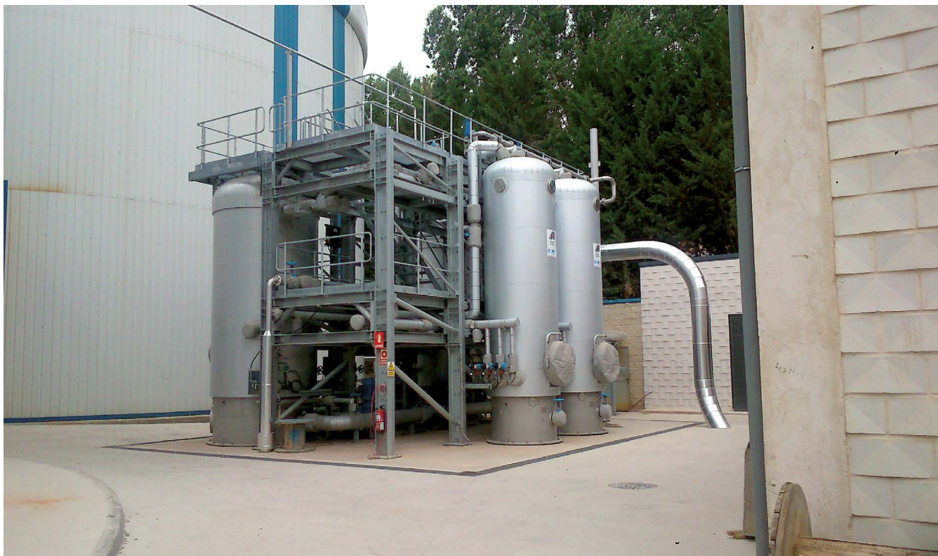
Planta de hidrólisis térmica Cambi THP B6.2 de la EDAR de Burgos. Foto facilitada por el autor del artículo.
